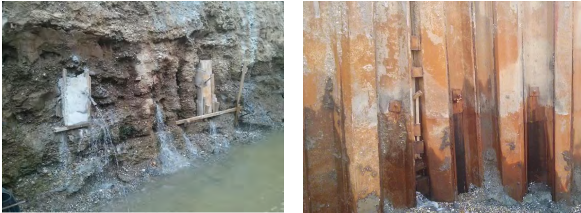
Slika 10: Vdor podtalne vode v gradbeno jamo [3]
