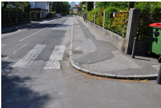
Slika 1: Primer poškodb na vozišču zaradi prekopov vozišča
