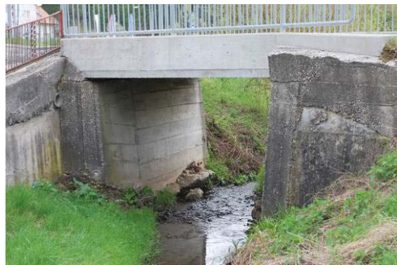
Slika 6: Neustrezna premostitev na potoku Grajena – bočna zožitev
