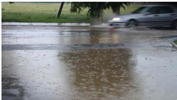
Slika 16: Poplave na novozgrajenem odseku Lackove ceste v Mariboru
