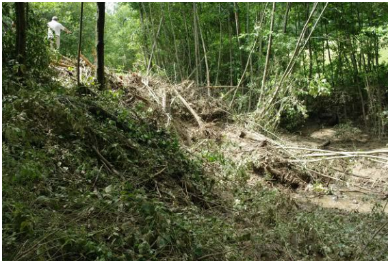
Slika 4: Poškodovana cesta zaradi zamašitve prepusta in prelivanja vode (foto: Blaž Ivanuša)
