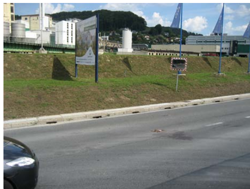
Slika 8: Požiralniki ob robniku vozišča regionalne ceste Celje – Zidani most v Laškem
