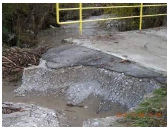
Slika 3: Most s premajhnimi mostnimi odprtinami in poškodovana cesta zaradi prelivanja vode ob mostu (foto: Boris Kmetec, Zdenko Zorič)
