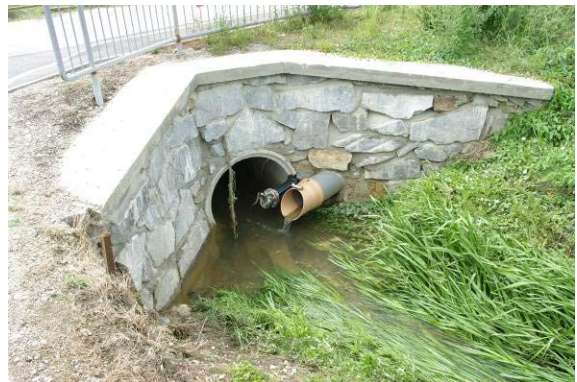
Slika 5: Ovirana pretočnost zaradi infrastrukturnih vodov (foto: Blaž Ivanuša)
